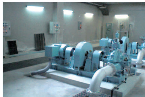
●和田浄水場 高効率ポンプ
