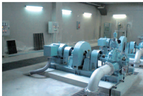
●和田浄水場 高効率ポンプ
