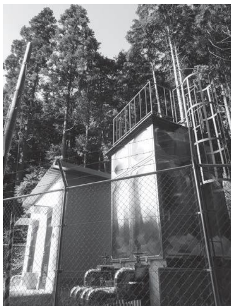
小川ポンプ所
