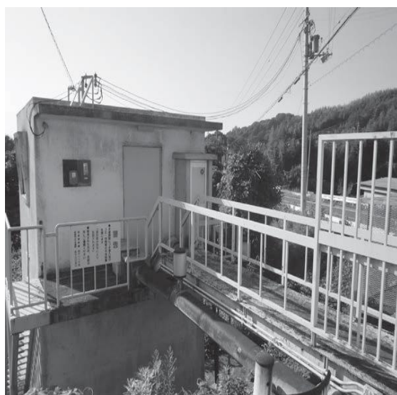
善正加圧ポンプ所
