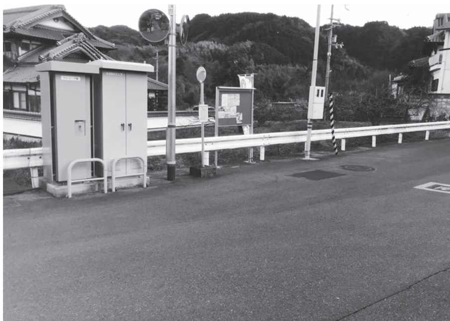
九鬼加圧ポンプ所
